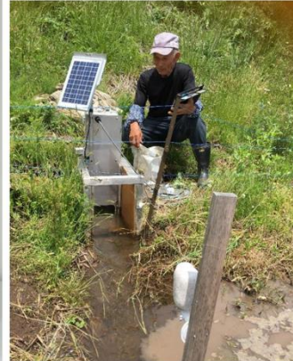
遠隔操作で水管理するための自動水門
